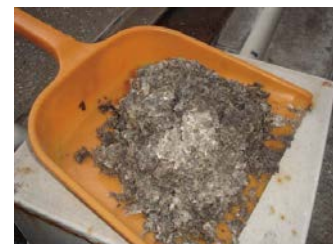
除去されたスケール
